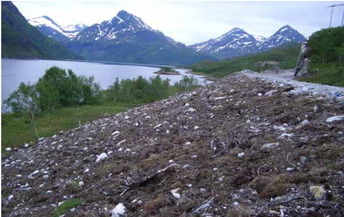
Figur 31: Enkelte strekninger langs Lofast II ble pusset over somrene etter at vegen var åpnet, fordi vegdistriktet mente utførelsen var blitt for røff. Foto: Kongsbakk
