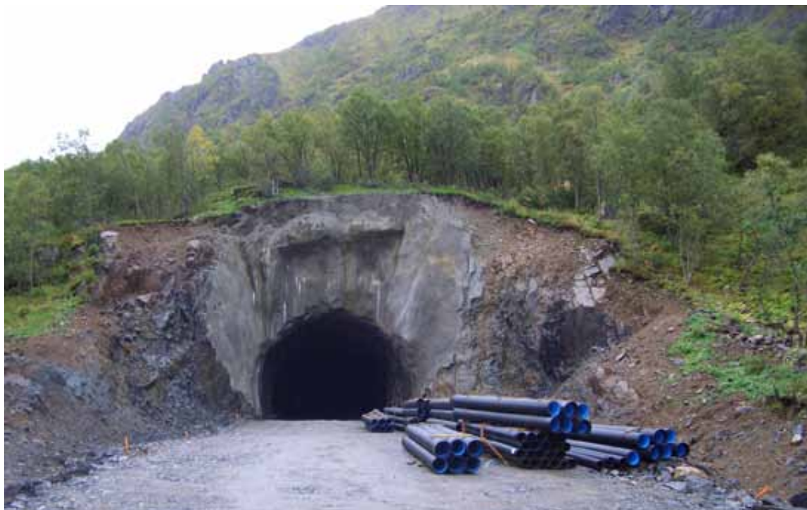
Figur 21: På steder som dette er det viktig at byggherren er våken. Det er som oftest bedre å ta noen meter mer i terrenget og få til ei stabil skråning som kan revegeteres, enn å tviholde på inngrepsgrensa. Foto: Kongsbakk
