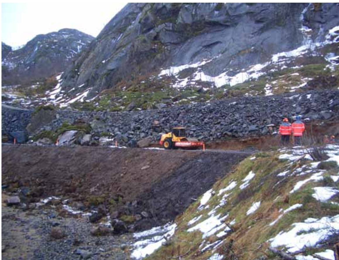
Figur 52: Det var ikke mulig å styre utlegging av vekstmasser bare til sommersesongen. Bratte fyllinger ble kledd parallelt med at de ble bygget opp til riktig høyde. Fra Svartskarvika. Foto: Kongsbakk
