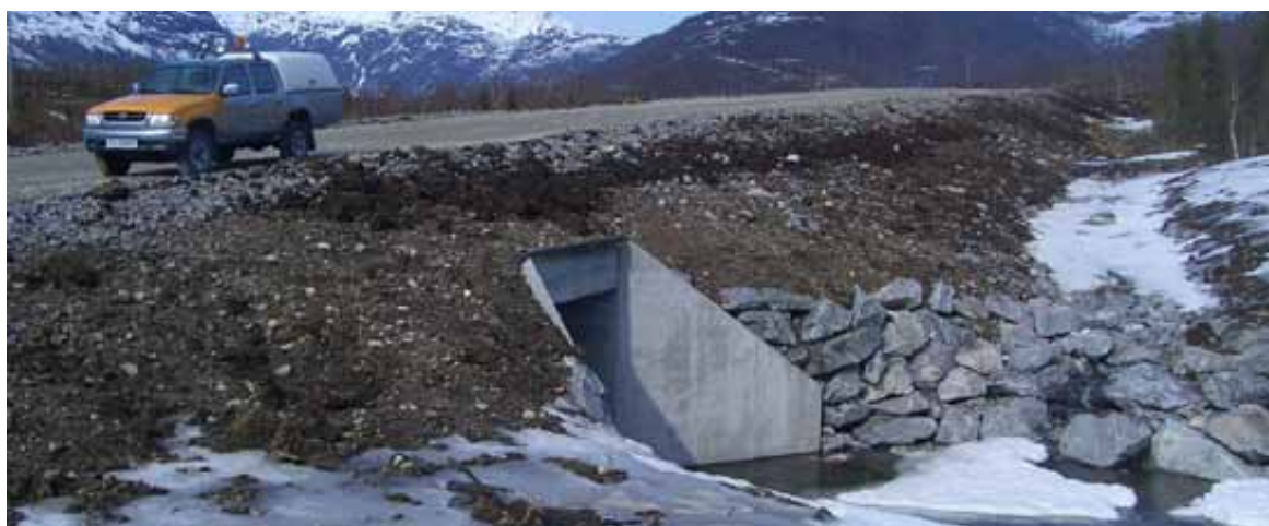
Figur 10: Høy årlig nedbør og forventede klimaendringer gjorde at drengssystemet ble kraftig dimensjonert. Foto: Kongsbakk
