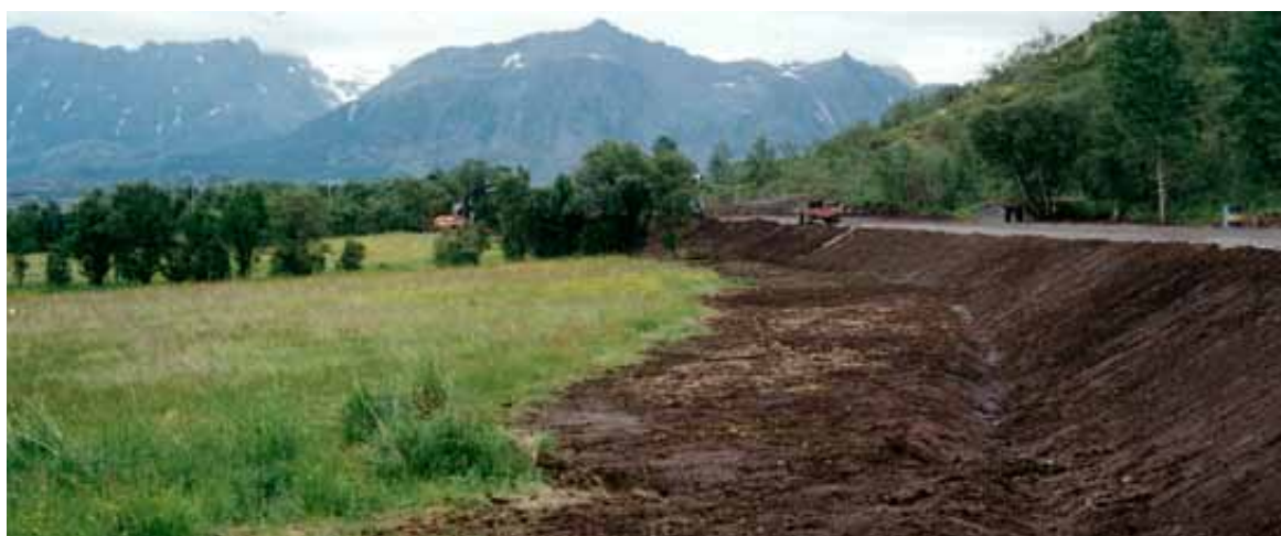
Figur 16: Dette bildet fra Lofast I viser hva som tradisjonelt sett har blitt oppfattet som godt maskinførerarbeid. Det var ikke dette byggherren etterspurte på Lofast II. Foto: Rosenfeld
