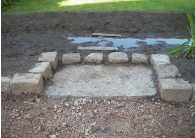
Figur 8. En helle med lave, åpne kantstein leder vannet inn i regnbedet. Systemet er en forbehandling av overvannet, og holder tilbake løv, kvist og søppel, som er lett å fjerne.
