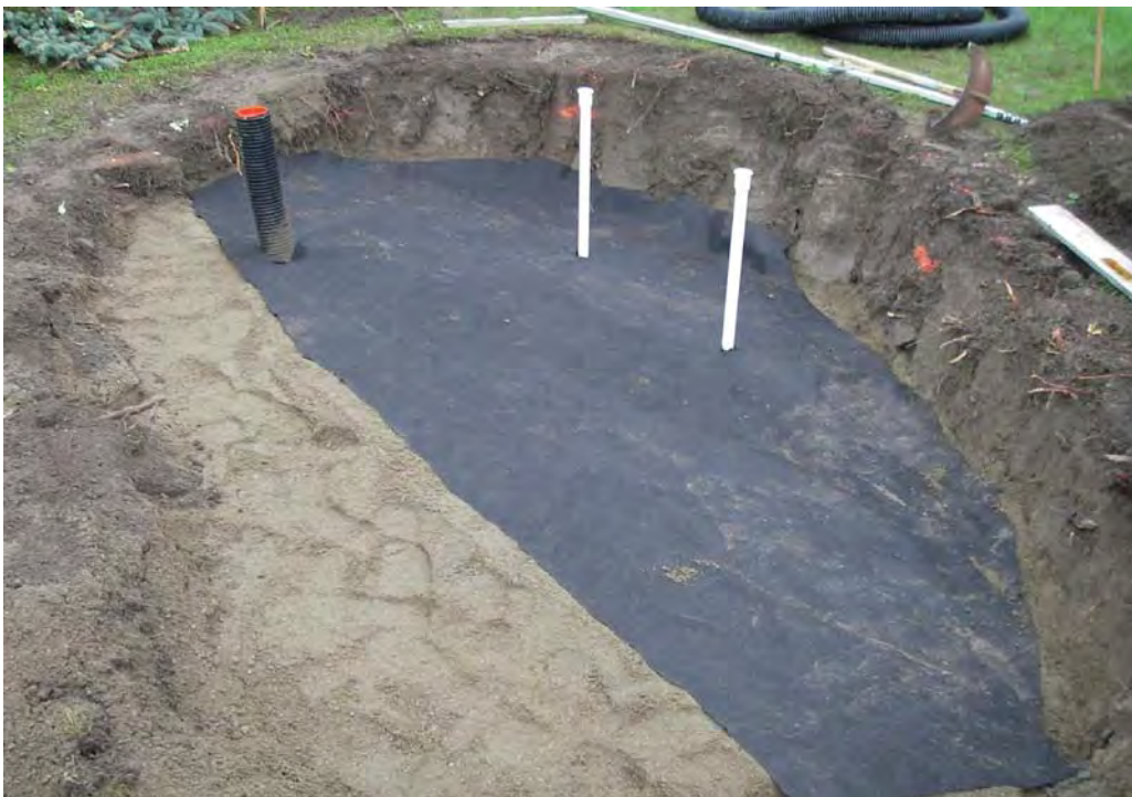
Figur 23. En fiberduk ble lagt mellom drenslag og filtermedium for å unngå at finstoff ble vasket nedover. I ettertid tviler vi på om den var nødvendig siden begge lag er sandjord. Kan fiberduken slemmes igjen og reduserer infiltrasjonshastigheten over tid, eller virke som en rotsperre?
