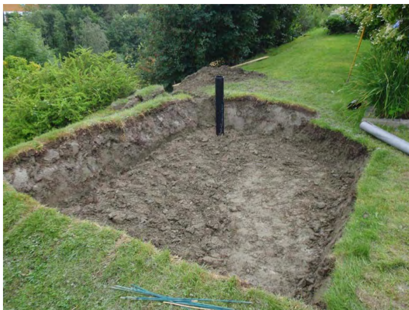
Figur 35. Filtermediet består av to lag. Stedegen siltig lettleire er fylt tilbake over drenslaget (figur 34). Det viste seg å redusere infiltrasjonen drastisk. Sandig jord legges som toppjord over lettleira (foto: RAG).
