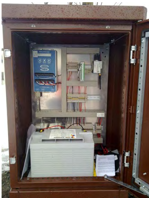
Figur 51. Instrumentskap plassert på fundamentet i figur 50: Sutron logger, automatisk mobiloverføring av data, 12V batteri for drift ved strømutfall, med mer.
