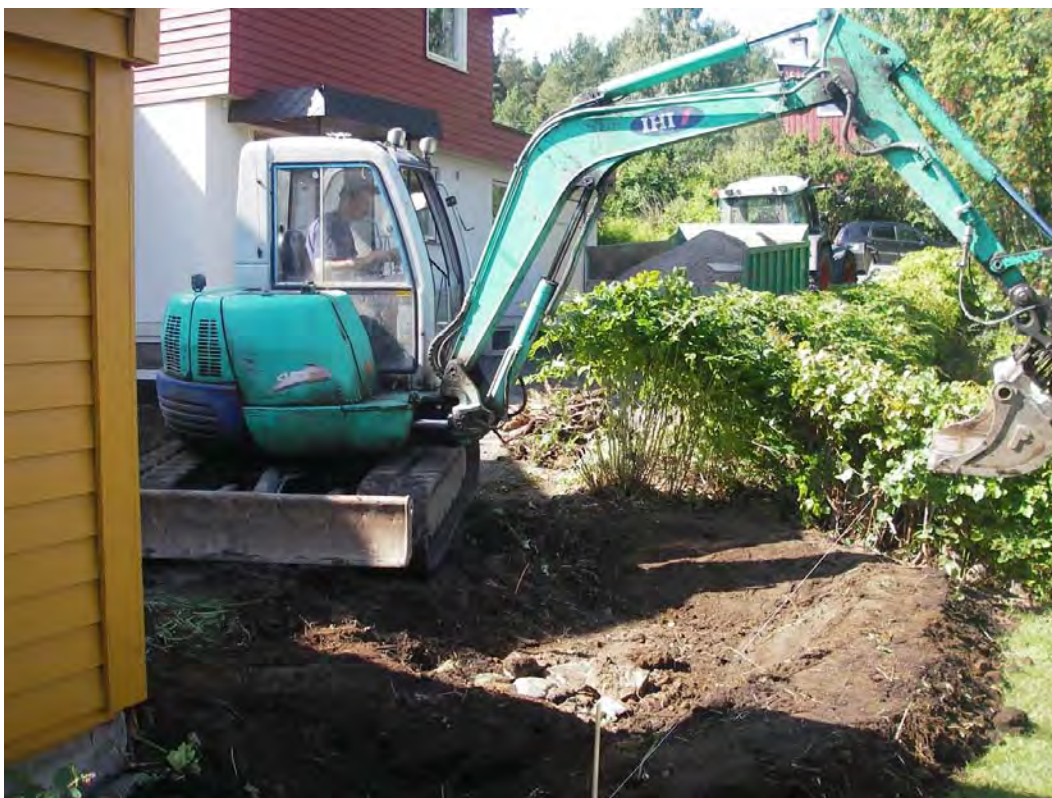
Figur 5. Kantsnor markerer regnbedets plassering. Sentralt i regnbedet graves overskuddsmasse av stor stein ned (steinkiste). Det ble ikke benyttet fiberduk rundt "steinkista", og den vil derfor trolig fylles med partikler over tid.
