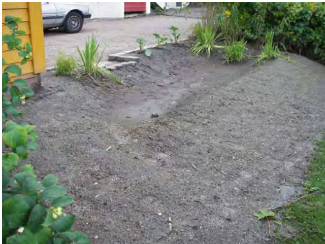
Figur 10. Utløpet leder overvannet inn på naboens plen, på samme måte som vannet har rent fra 1964. Det er imidlertid svært sjelden vann går i overløp (mindre enn en gang per år). Vanndybden før overløp er kun 6,5 cm. Vanligvis er dybden 15-30 cm (figur 2).
