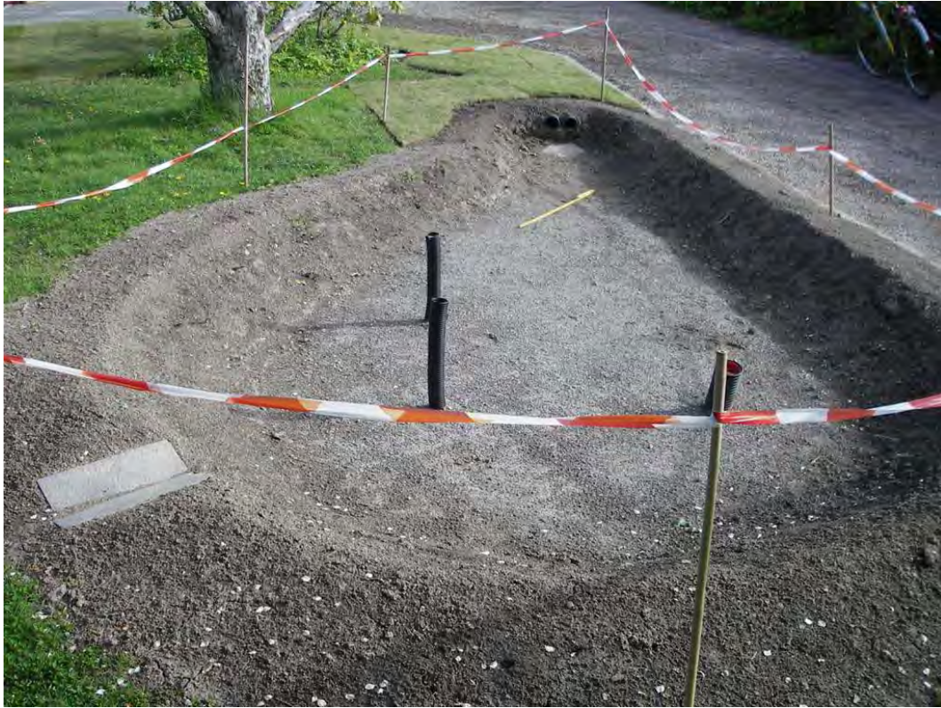
Figur 28. Ferdig regnbed før tilplanting. Under innløpsrør er en skiferhelle plassert for å hindre erosjon i regnbed bunnen. En liten stein ble satt i enden av skiferhella seinere, for å redusere vannets hastighet inn i regnbedet. Et V-formet overløp av to skiferheller leder vann til plen ved svært store nedbørintensiteter. Drensrøret til høyre har et perforert lokk som overvannet kan renne ned i. Drensrørets innløp er ca 5 cm lavere enn overløpet.
