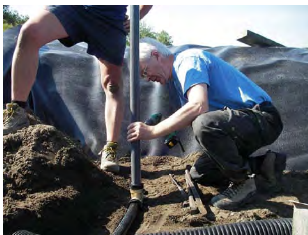
Figur 52. Markvannsrør ved overløpet (V-ut) gjennomhulles 10 cm under regnbedoverflata og mot bunnen av filtermediet for å kunne følge vannstanden i filteret. Røret gjennomhulles også ca 5 cm over filteroverflata (regnbedbunnen) og oppover for å måle vannstanden i regnbedet og eventuelle overløp. Trykksensor ligger i trekkerøret ved koblingen i messing (foto: AE).
