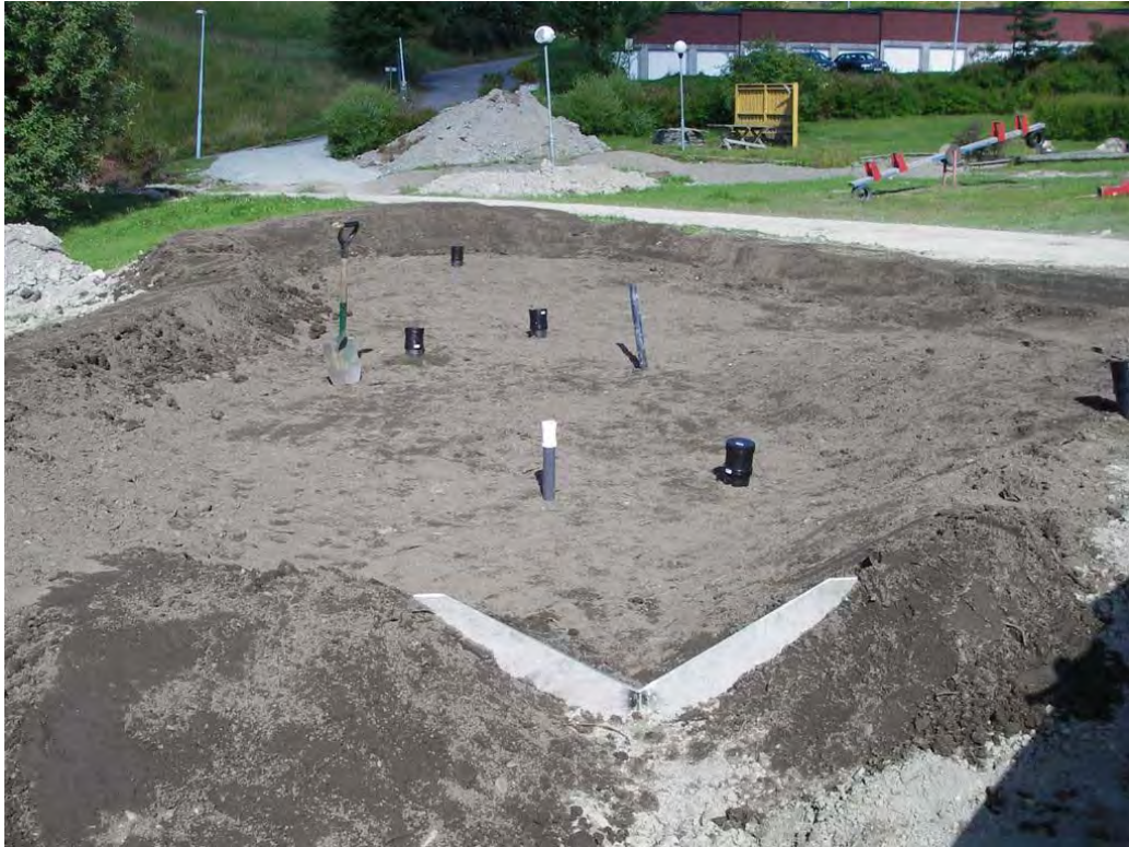
Figur 45. Ferdig anlagt regnbed på Risvolla sett fra utløpet. Bremmen er dekket med samme jord som filtermediet. Enden på drenerørå går i dagen for å lette evt. vedlikehold og muliggjøre for infiltrasjon som i NB21 (figur 28).
