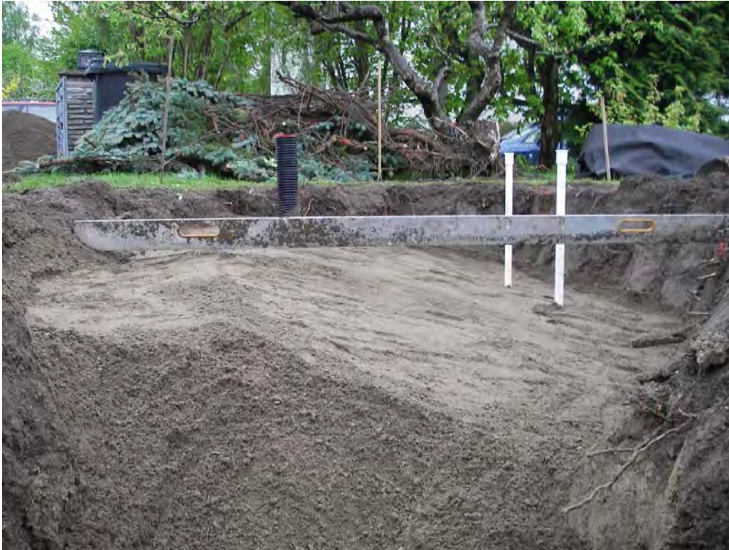
Figur 22. For å sikre meget god infiltrasjon, er drenslaget skråstilt slik at det når regnbedoverflata. 100 mm drensrør sees i bakgrunnen. To hvite markvannsrør står til høyre. Disse er for måling av vannstanden i drenslaget og i filtermediet.
