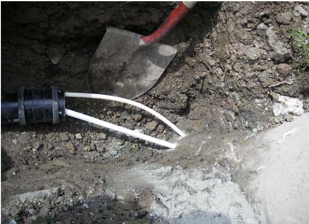
Figur 27. Drensrøret er avsnørt og to mindre rør med forskjellig kapasitet, leder vannet inn i overvannskummen. Blending av ett rør er derved mulig. Maksimal avrenning i begge rør, ble målt til 0,6 l/s, men var vanligvis mye lavere.
